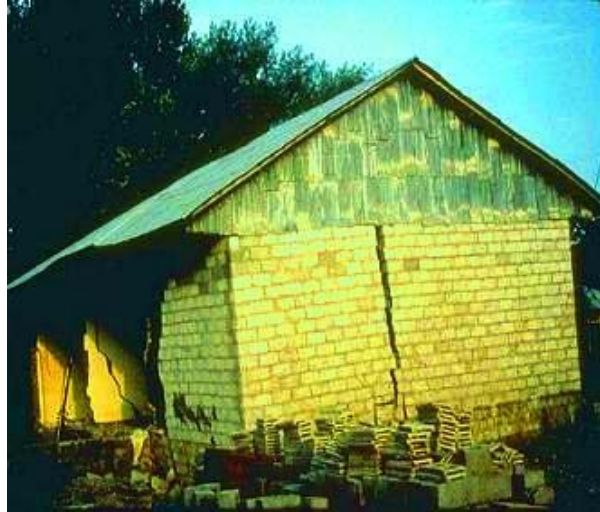
Gambar 5 Contoh kasus kegagalan konstruksi akibat penurunan konsolidasi (sumber: http://civil-engg-world.blogspot.com )
