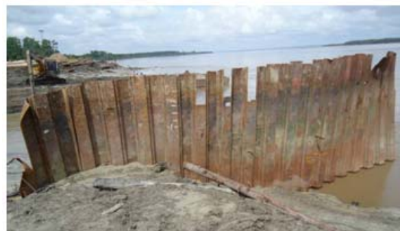
Gambar 2. Sheetpile yang mengalami kegagalan di lokasi dermaga.
