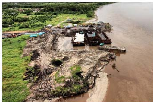
Gambar 1. Kondisi dermaga setempat akibat erosi arus Bono.
